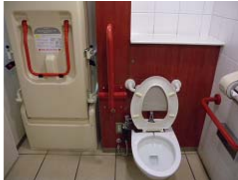
多機能トイレ内 便器にはオストメイト簡易型設備が 設置されている
