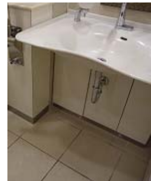
多機能トイレ内の洗面器
