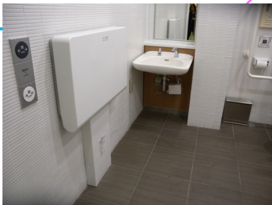
多機能トイレ内部： おむつ替えシートと洗面台
