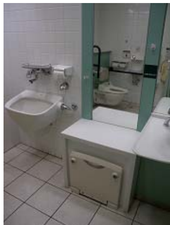
写真① 汚物流し(左)と着替え台(中央)
