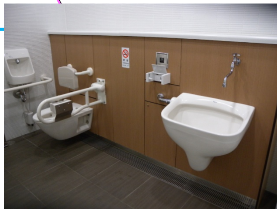
多機能トイレ内部： オストメイト用汚物流しなど
