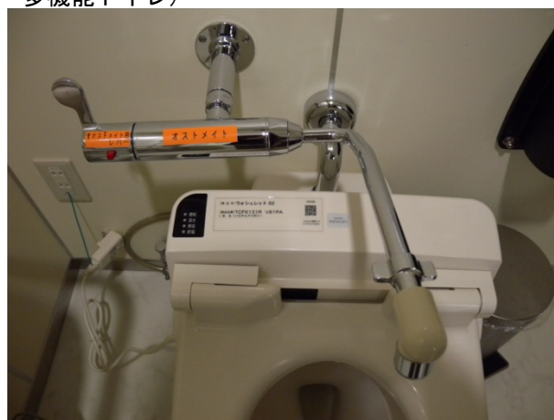
オストメイト簡易型設備（7F多機能トイレ）
