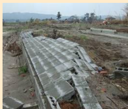
崩壊したブロック塀(b) (亶理町, CB造)
