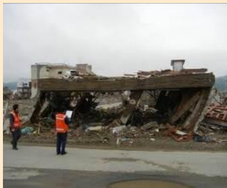
層崩壊した建築物(a) (陸前高田市, RC造平屋)
