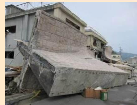
崩壊・転倒した防潮堤(e) (山田町, RC造)
