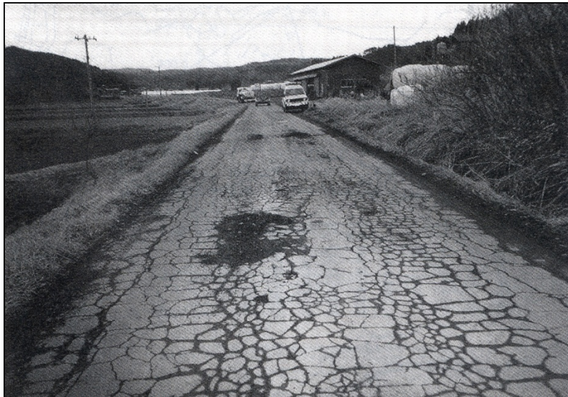
舗装剥離による穴
