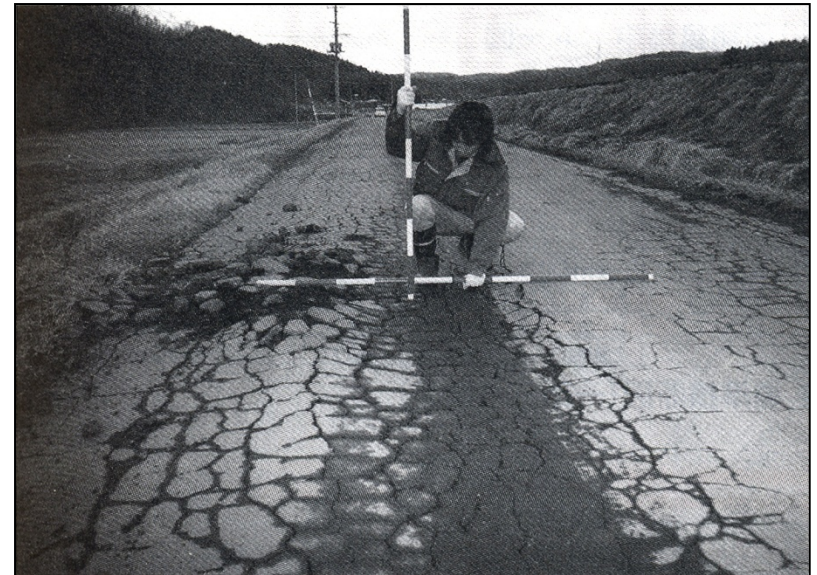
土の噴出と舗装面のクラック
