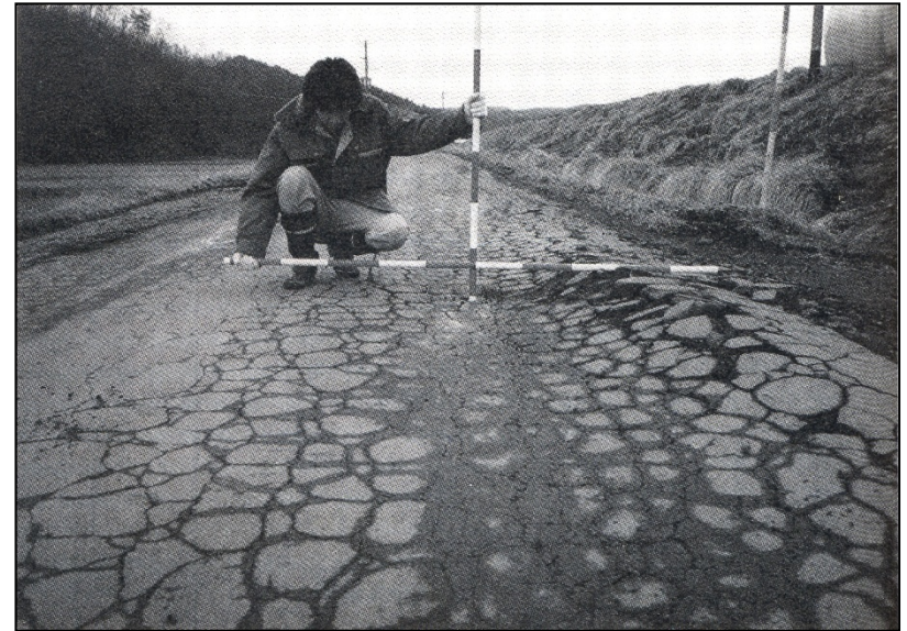
舗装面の盛り上がり、沈下
