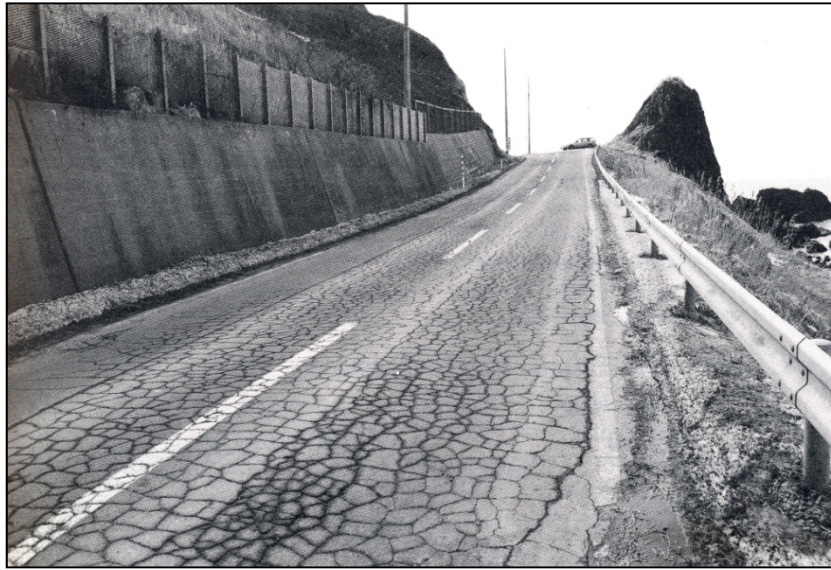
舗装面の亀甲状クラック
