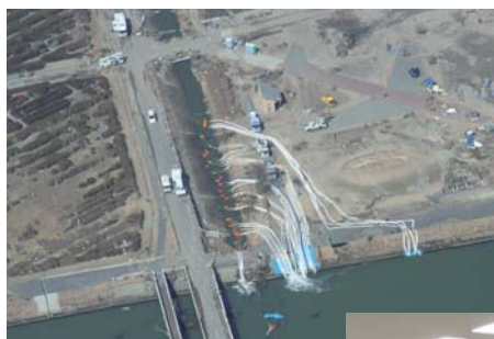
仙台空港は東北地方整備局のヘリコプター「みちのく号」が飛び立った後、間もなく浸水。空港に大量に溜まった水を排水するため排水ポンプ車を集中投入し、4月13日には空港が再開した。
