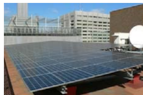
太陽光発電システム
