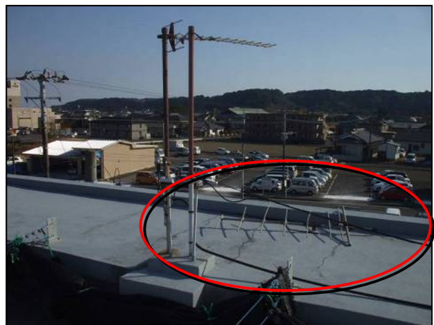
〈屋上に放置された不要物〉
