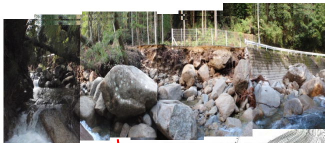
路肩擁壁の崩壊
