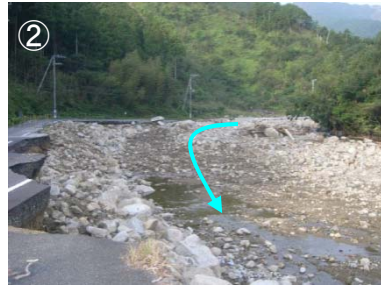
② 流路屈曲部の既設道路は洗掘を受け崩壊
