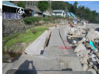
④ 護岸損傷
