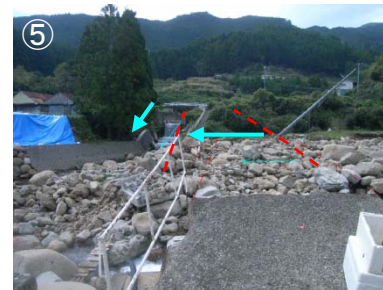
⑤ 河道が閉塞し川原橋が落橋
