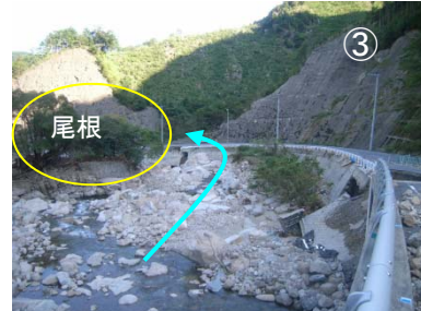
③ 峠橋下流の被災状況
