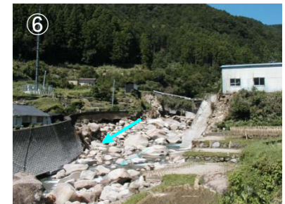
⑥ 河床洗掘、護岸基礎の破壊
