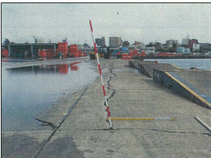
エプロン上の沈下とクラックの状況
