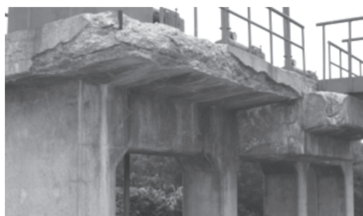
凍害劣化等の結果生じたはく落
