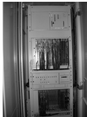
【変電所施設の一例】
