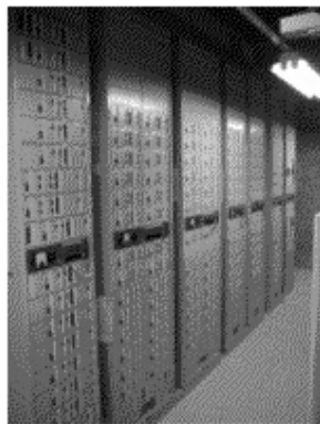
【列車制御施設の一例】
