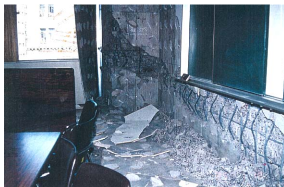
内部の被災状況
