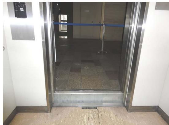
エレベーター着床時の段差
