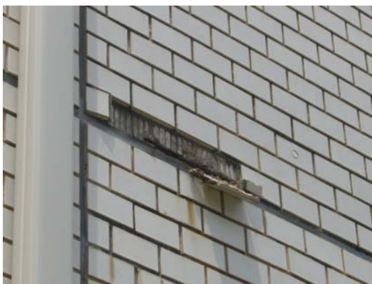
落下した外壁タイル
