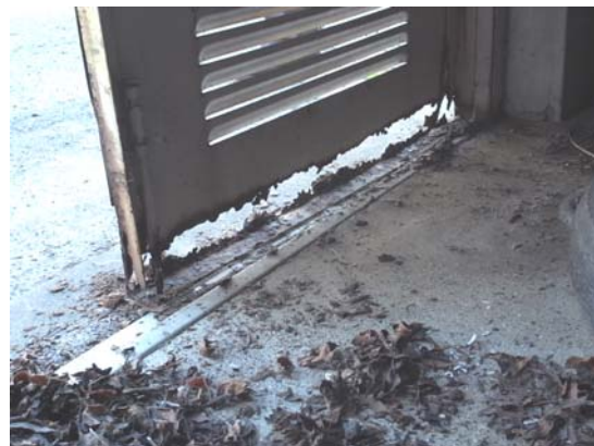
腐食した建具
