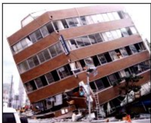
事務所ビル1, 2階の崩壊
