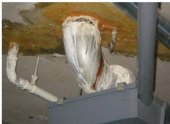
亀裂のある排水管
