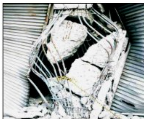
店舗1階柱の圧壊
