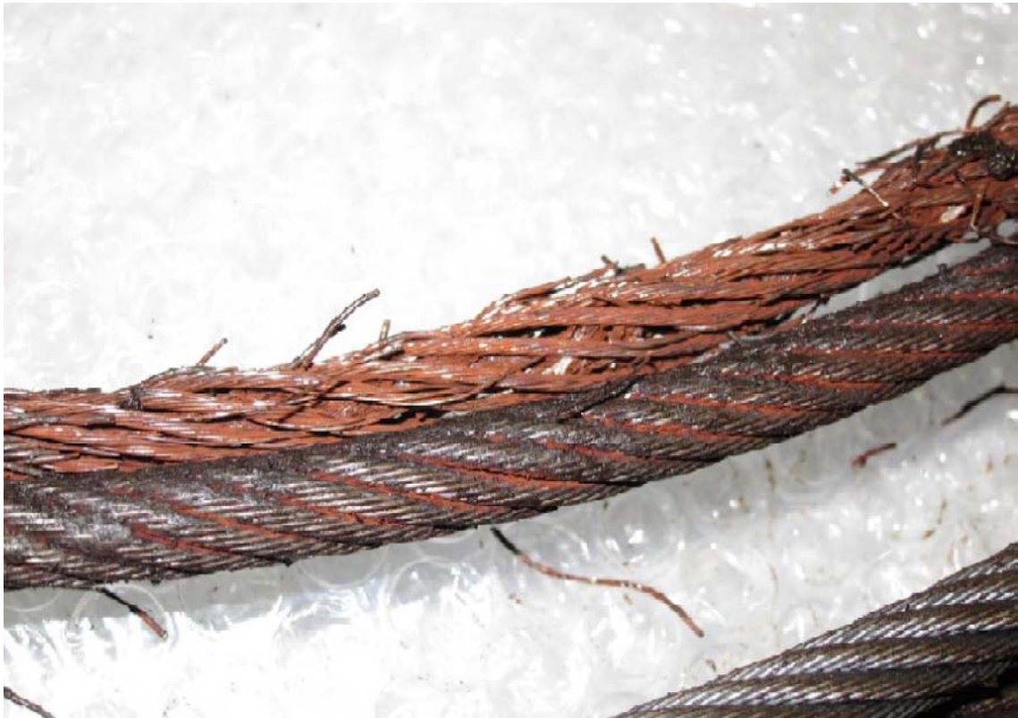
写真 1 3 渋谷駅東口歩道橋未破断ロープ
