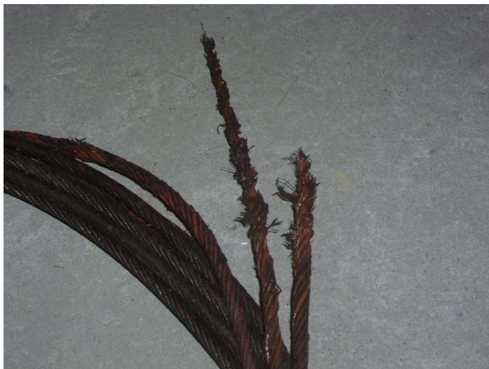
写真4 ロープA, B破断部
