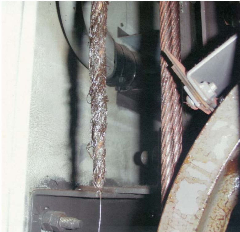
写真 1 1 渋谷駅東口歩道橋ロープ破断部および未破断ロープ
