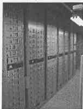
【列車制御施設の一例】
