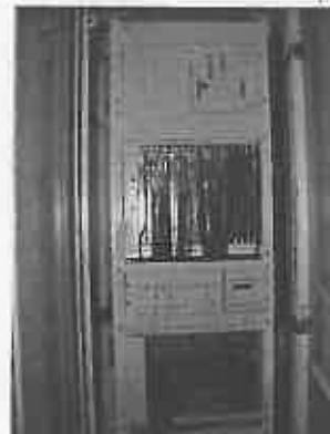
【変電所施設の一例】
