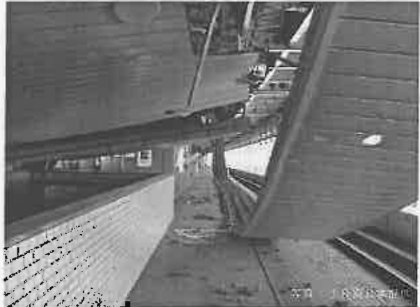
天井材の落下例
