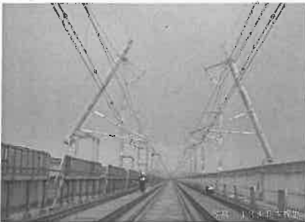
電車線柱の折損例
