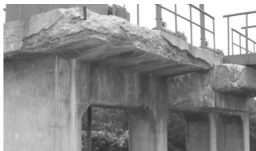
凍害劣化等の結果生じたはく落
