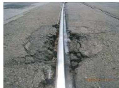
軌道敷等施設老朽化
