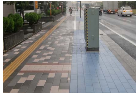
■ 自転車通行部分に 地上機器(変圧器)が存在している例
