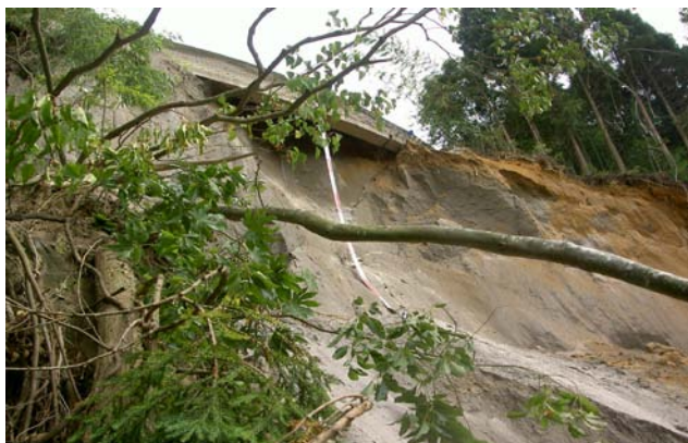
シラスが侵食され、 ブロック積の背面 が空洞化
