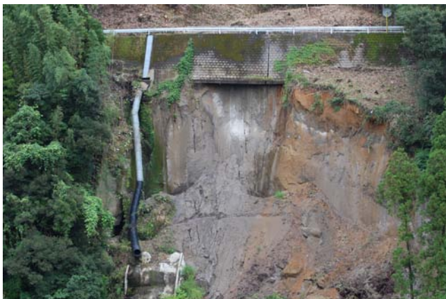
道路路側のシラスが 侵食され、地山が崩落
