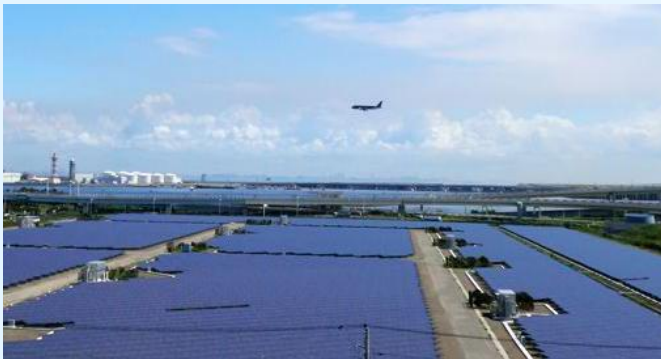
浮島太陽光発電所
