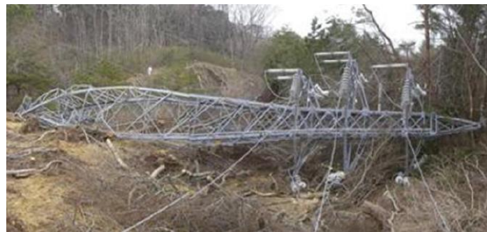
地すべりにより、鉄塔倒壊
