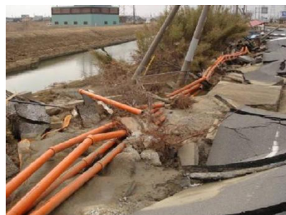
路盤崩壊による 管路損傷
