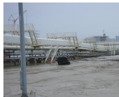
液状化と津波により、 石炭火力発電所の 輸送コンベアが蛇行
