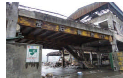
図4 津波被害を受けた釜石魚市場
