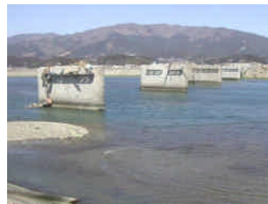
図2 寸断された国道45号 (陸前高田市 国道45号 気仙大橋)
