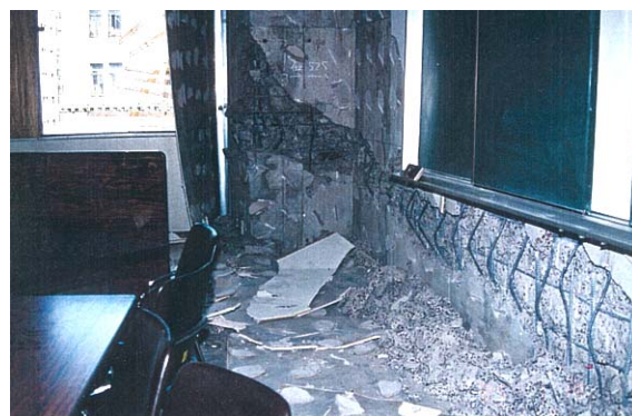
内部の被災状況
