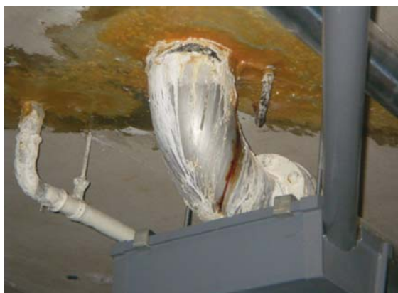
亀裂のある排水管
