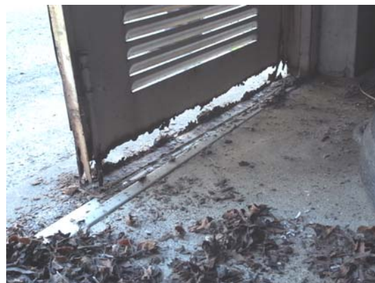
腐食した建具
