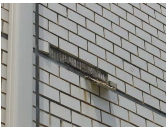
落下した外壁タイル
