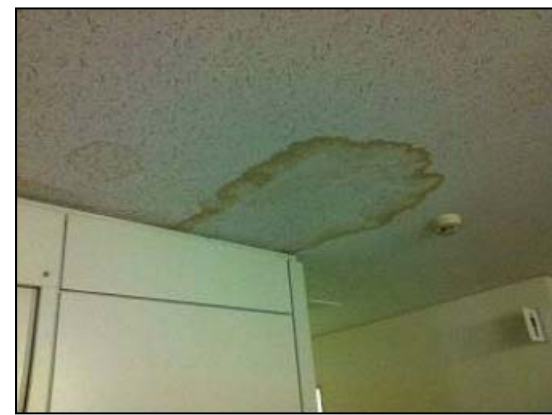
廊下部分 : 漏水のあと有り。天井裏の配管からの漏れかと思われる。
