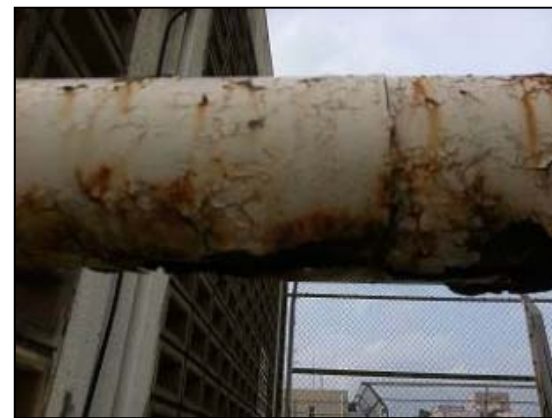
屋上配管類 : 鋼製配管に劣化が広範囲で見られる
