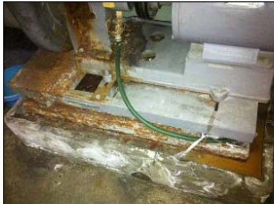
機械室内 : 設備機器に劣化が見られる
