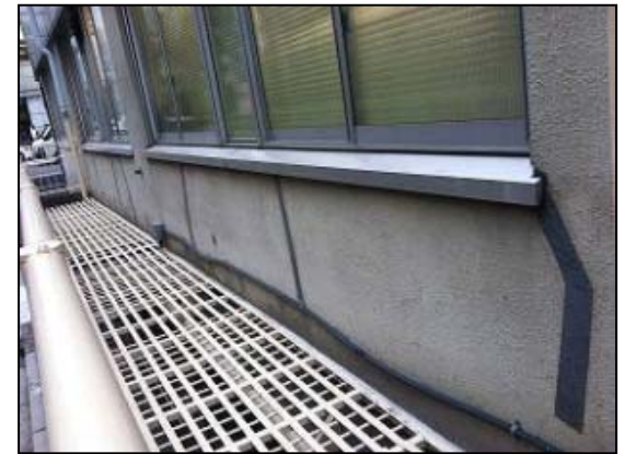
外周廻り : かなり大きめのクラック補修あと有り
