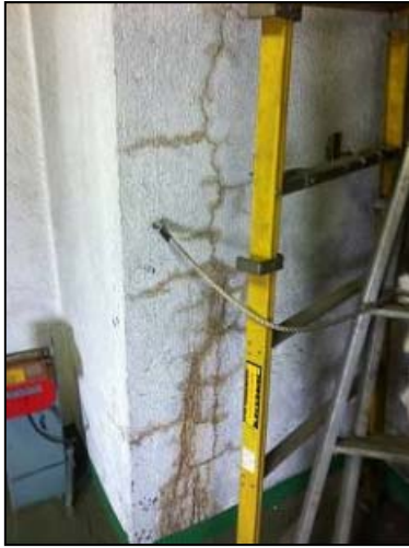
EV機械室 : 柱にクラックが生じ、錆汁が出ている
