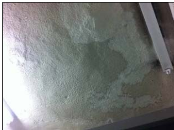
書庫内 : 天井スラブに漏水のあと有り。モルタルも浮いている状況
