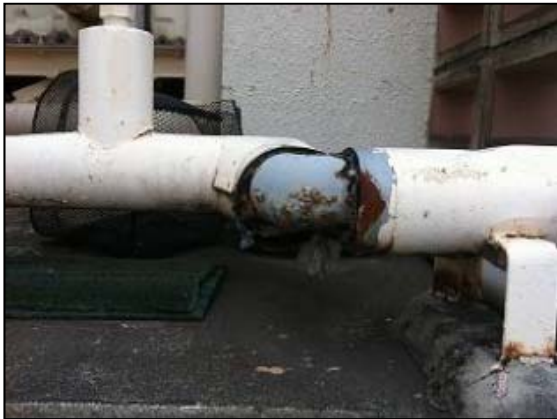
屋上配管 : 保温材が切れている箇所有り
