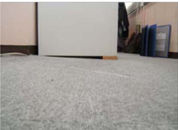
執務室内 : 床の傾斜状況
