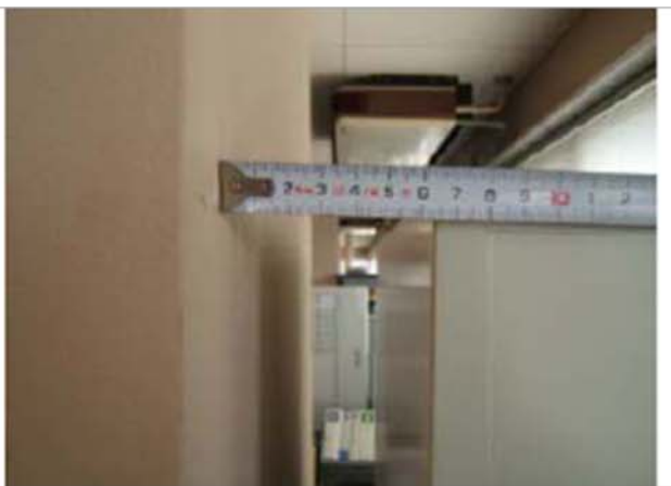
執務室内 : キャビネット(H1,690mm)上部 開き(65mm)→床の傾斜度約1/25
