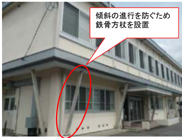
2階床はね出し部分の傾斜
