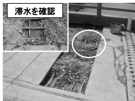
凍害劣化等による道路橋床版の砂利化現象
