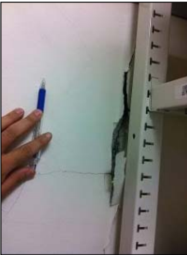
書庫内 : モルタルの剥離有り
