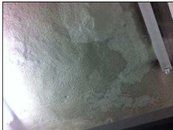
書庫内：天井スラブに漏水のあと有り。モルタルも浮いている状況
