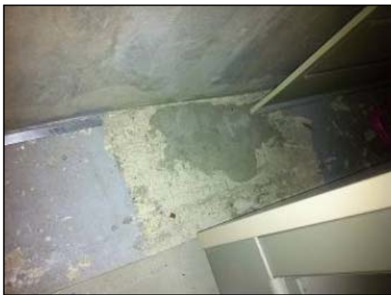
書庫内：床部分及び壁にも漏水のあと有り
