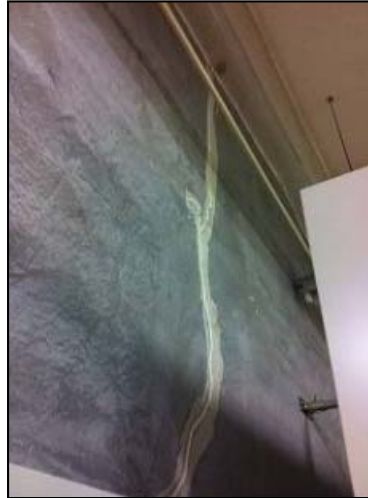
内壁 : 書庫内コンクリート壁にクラック補修のあと有り
