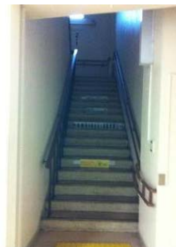
階段の踏面が26cm程度しかなく、スパンとの関係からスペース的にも改修が不可
