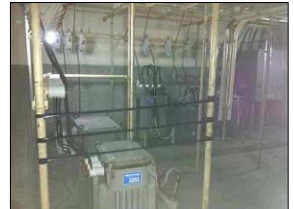
電気室 : 旧式の電気設備であり、老朽化が見られる
