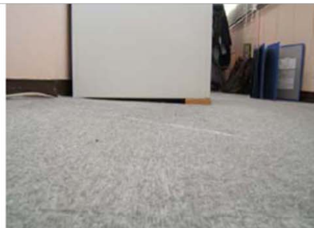
執務室内 : 床の傾斜状況
