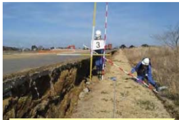
被災状況調査班(河川)
