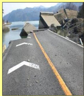
津波で被災した国道45号
