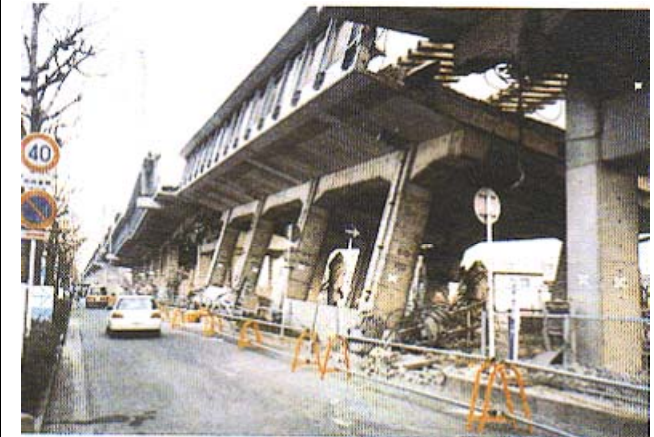
(参考) 阪神・淡路大震災(平成7年1月17日発生)における山陽新幹線の高架橋の倒壊状況
