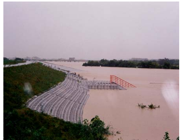
写真-2 豊城1号樋門（鵜川）増水時
