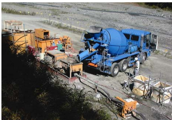
写真一 レミコン方式プラント
