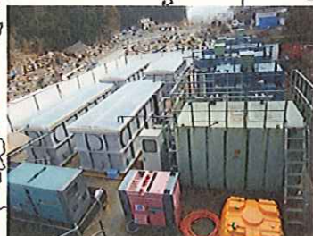
膜処理ユニットによる処理場と別位置での応急対応状況(陸前高田市)
