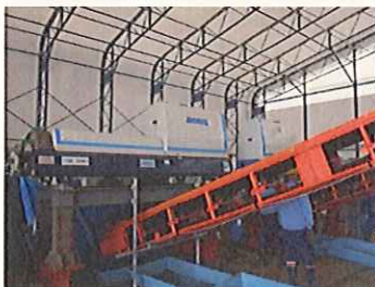
仮設脱水機 (仙台市 南蒲生浄化センター)
