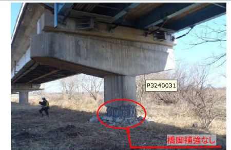
【耐震補強無し】橋脚が地震動により損傷
