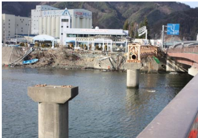
落下した水管橋 平成23年3月28日
