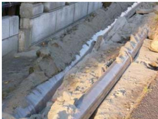
管きよの浮上・破断
