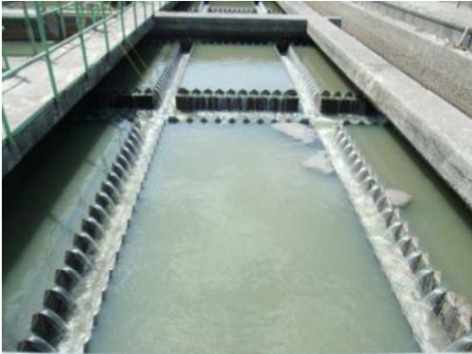
仙台市南蒲生浄化センター
