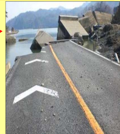
▲津波で被災した国道45号
