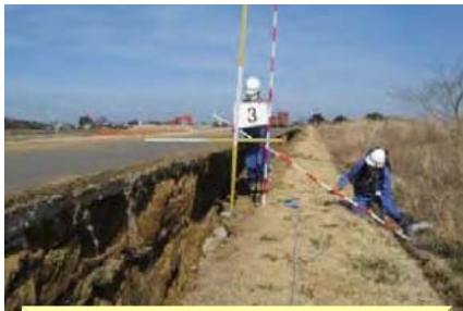
被災状況調査班(河川)
