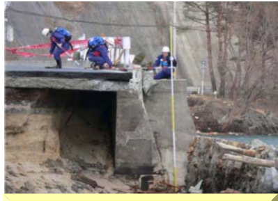
被災状況調査班(道路)
