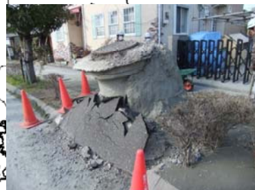
液状化により隆起したマンホール (千葉県 浦安市)
