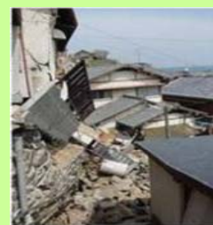
○多くの家屋が損壊被害
