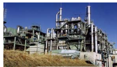
下水汚泥焼却炉
