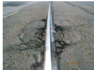
軌道敷等施設老朽化
