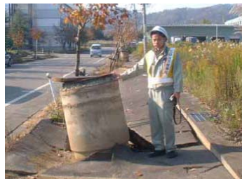
マンホールの突出
