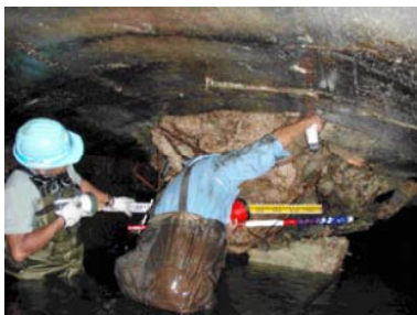
約11mにわたって岩盤が崩れた現場=広島県企業局提供
