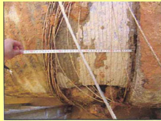
PC管: カバーコートモルタルの欠損とPC鋼線の破断
