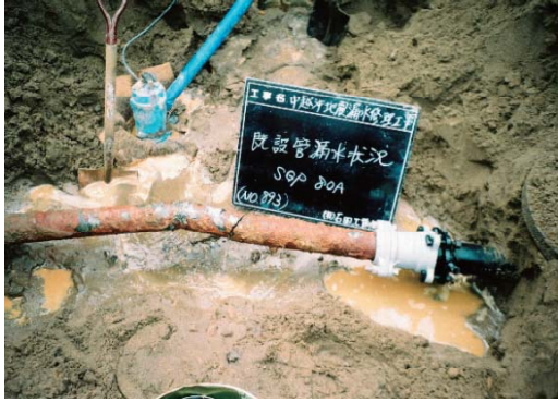
埋設管の漏水
