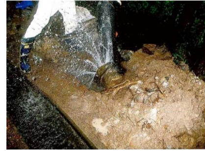
水道管の被害の例
