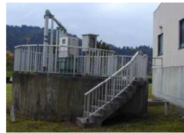
汚泥濃縮タンクの傾き
