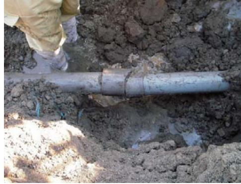
継ぎ手の破損
