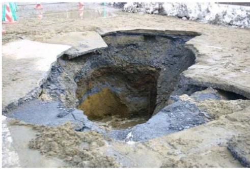
破断による道路の破損
