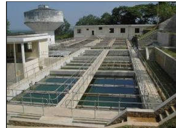
Marimbada WTP (Matara)
