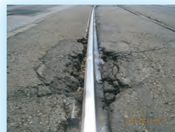
車両軌道敷等の施設の老朽化
