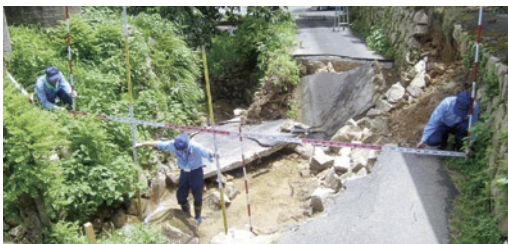
被災状況調査活動を行う
