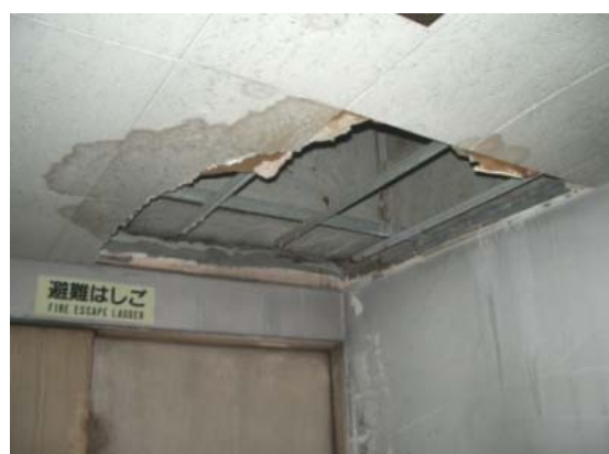
屋内への漏水
