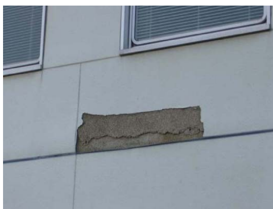
落下した外壁パネル
