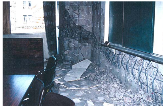
内部の被災状況
