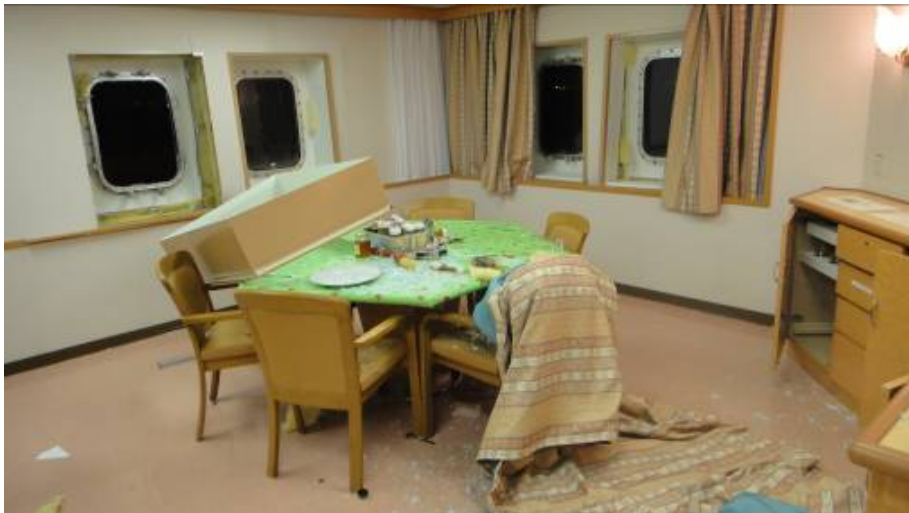
士官食堂の窓ガラス・窓枠破損
