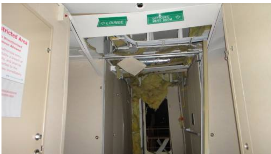
右舷ドアの破損
