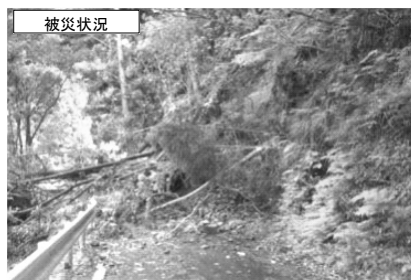
道路で崖崩れが発生
