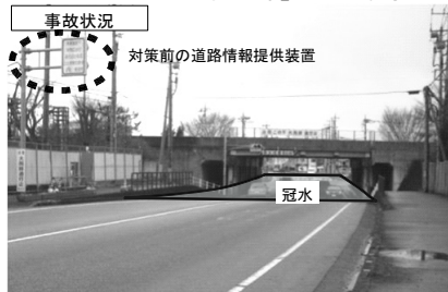
冠水した道路へ車両が進入する事故が発生
