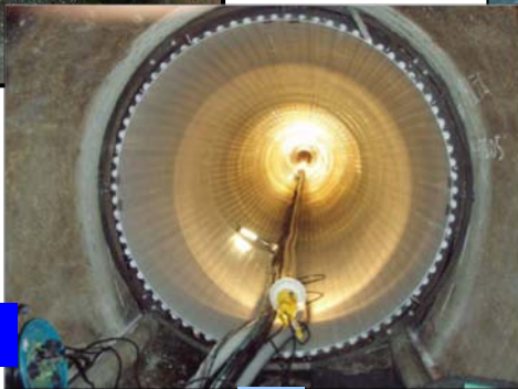
水密ゴムの破断による漏水状況
