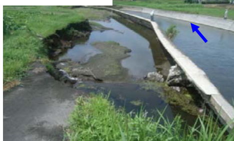
護岸の浸食状況
