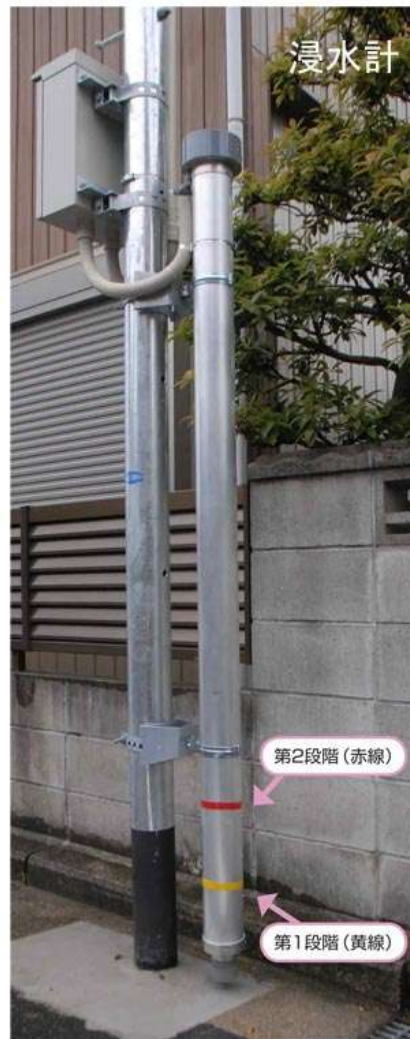
市街地に設置された浸水計
