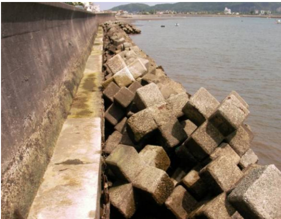
護岸の基礎が現れている
