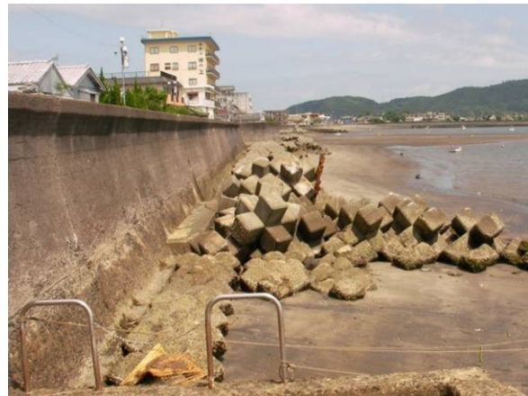
護岸の根固めブロックが飛散している
