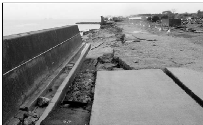
【被災した海岸堤防(平成16年度)】
